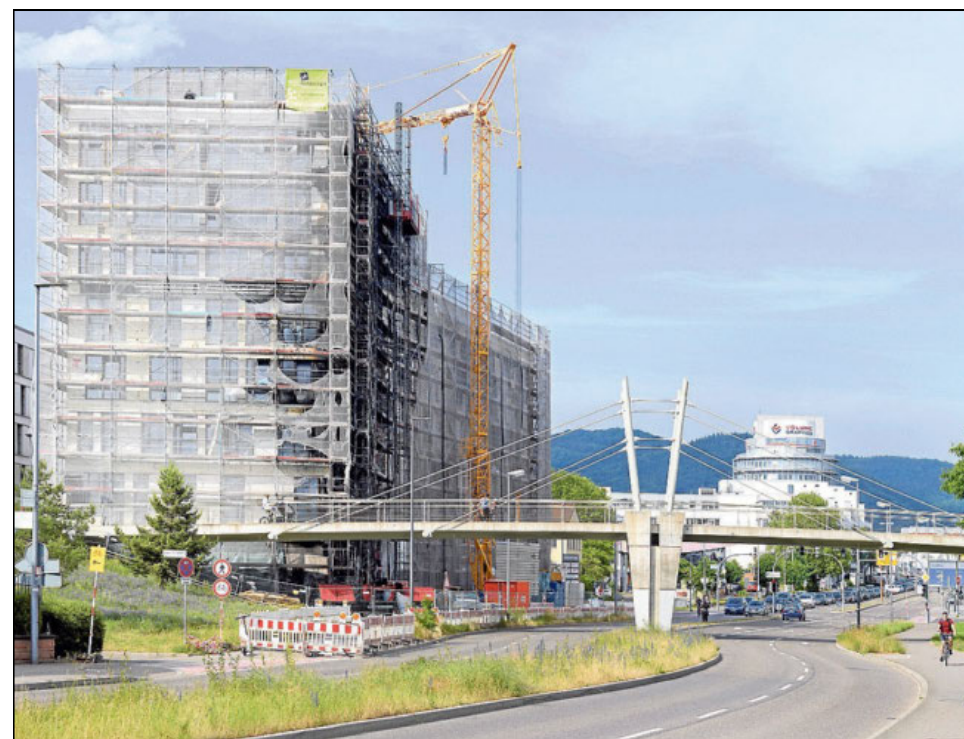
Die Ostfassade des „Stadttor West“ brannte am Freitag lichterloh. Das Feuer soll sich aus einem Schmelzbrand zwischen Abfallcontainern und Gebäudesockel entwickelt haben. Foto: Rothe
